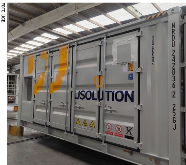
Sistema de armazenamento em Extrema, Minas Gerais.
